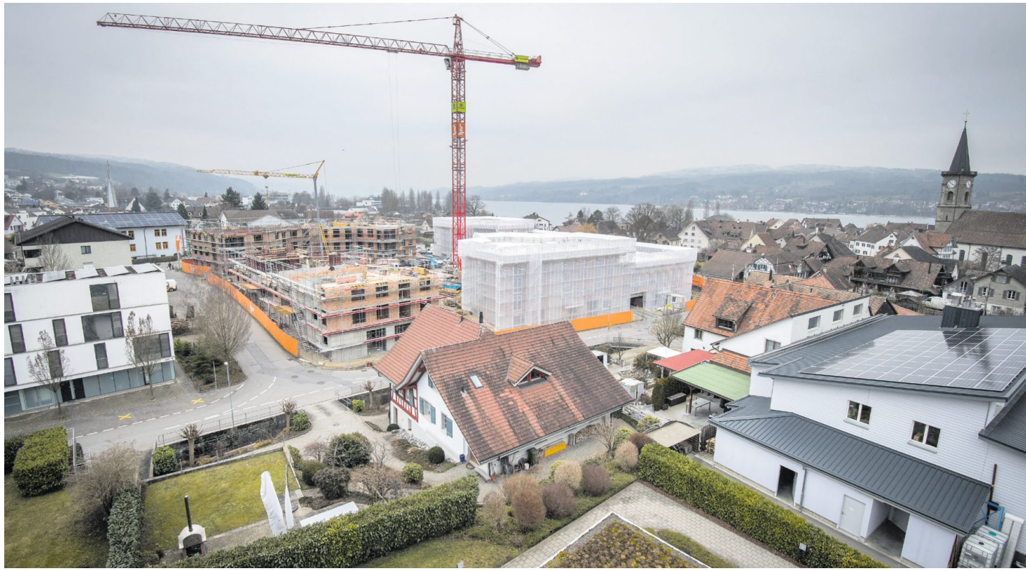
Seit Monaten laufen die Bauarbeiten an den vier geplanten Gebäuden auf dem Lindenareal.
